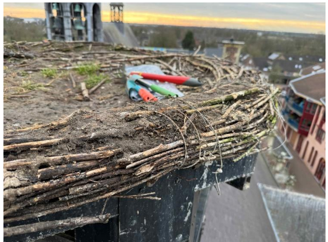
Rand ook helemaal aan het verweren.
